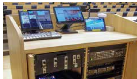
教壇脇の操作卓。右のタッチパネルは日英の選択が可能。 下部にはデジタルマルチスイッチャーなどを収納している。
