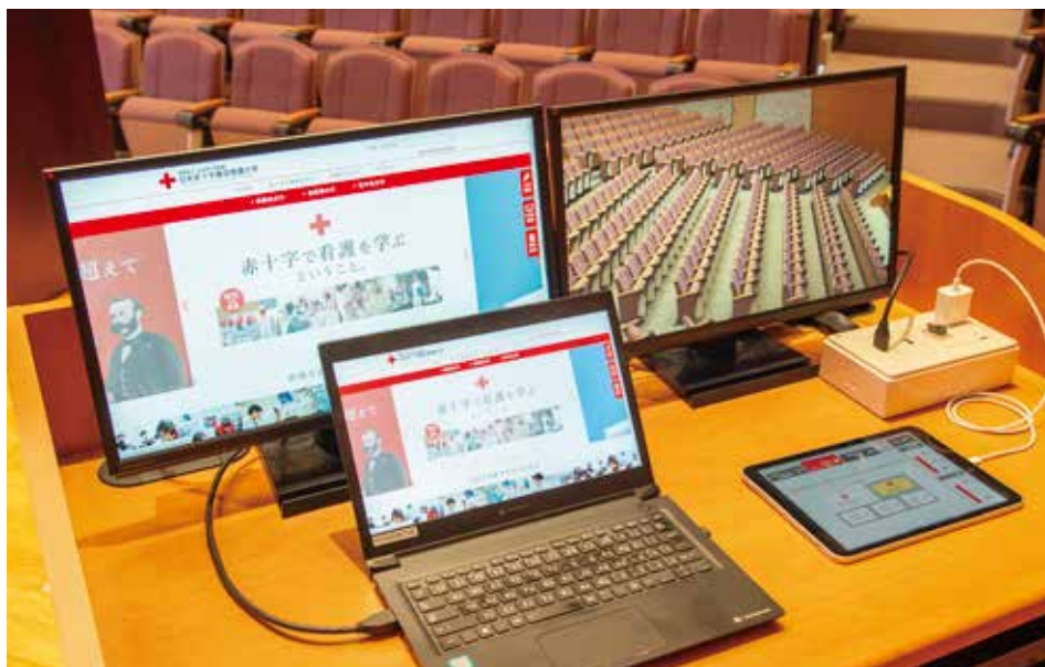
講堂のシステムは、タブレット端末でコントロールするので、講堂の客席からでも映像・音響操作が可能。同様のシステムが、講堂の後方上部にある調整室にも設置されている。
