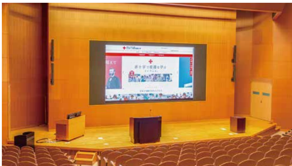
講堂の舞台に設置した200インチのLEDビジョンは、どの席からでも明るく、クリアな映像を見ることができる。舞台の脇にある演台（左下）には、映像・音響のコントロールシステムを設置している。
